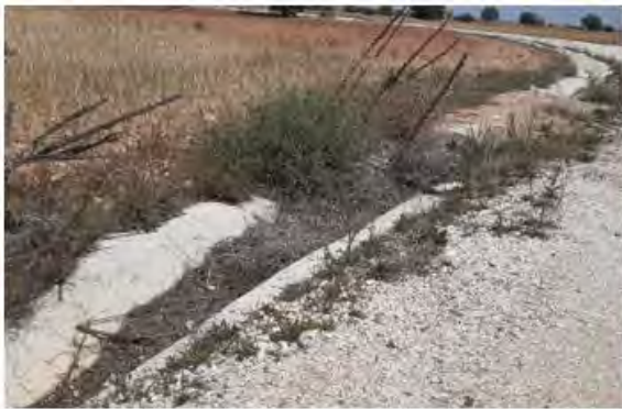
Fig. 3 Cuneta llena de vegetación arbustiva en vial de acceso al aero MO1.10
