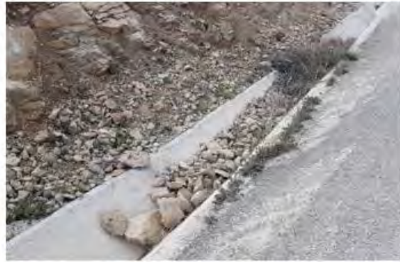
Fig. 2 Cuneta llena de sedimentos en vial de acceso al PE MO1
