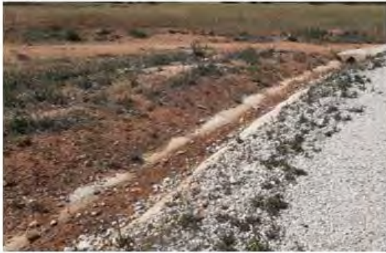
Fig. 1 Cuneta llena de sedimentos en vial de acceso al aero MO1.05
