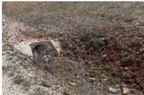
Fig. 4 Tubo de drenaje semitaponado por vegetación arbustiva en vial de acceso al aero MO1.05
